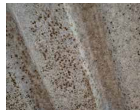
Vliesbeschichtung mit Schimmelbildung durch unzureichende Lüftung (Beispiel)
